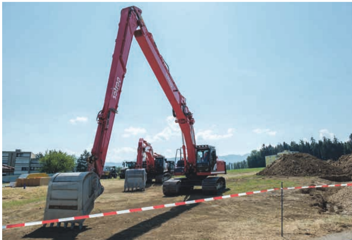
Les forages géothermiques débuteront fin juillet, une fois les modèles numériques du terrain affinés
