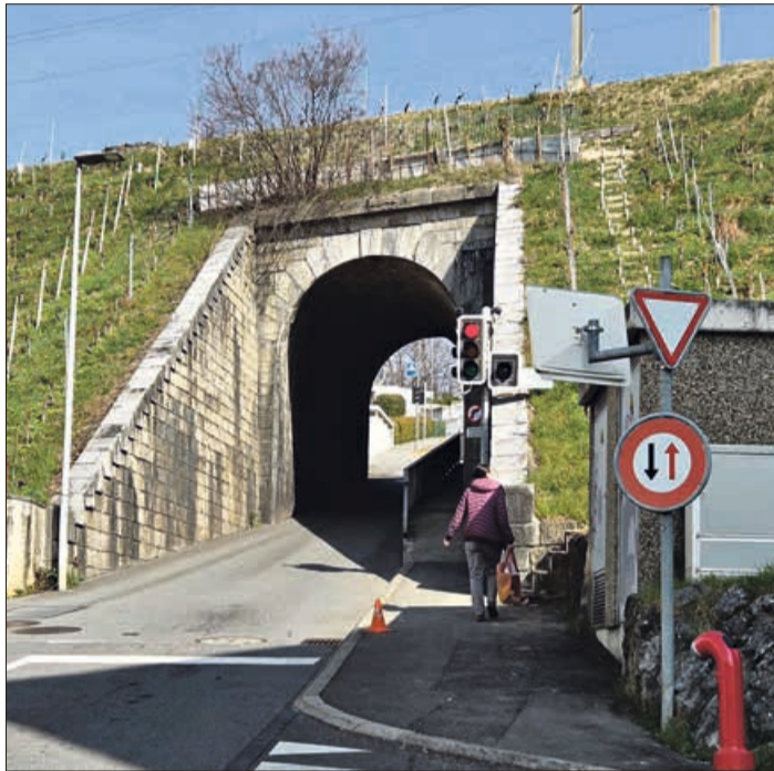
Le trottoir du tunnel est devenu glissant. Un nouveau revêtement est prévu
