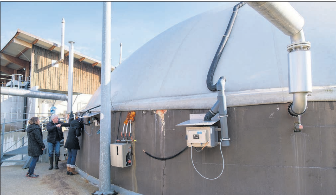
La centrale à biogaz de Palézieux-Village couvre les besoins en électricité du collège situé à quelques mètres et de 650 ménages, soit l'équivalent de 2000 habitants
