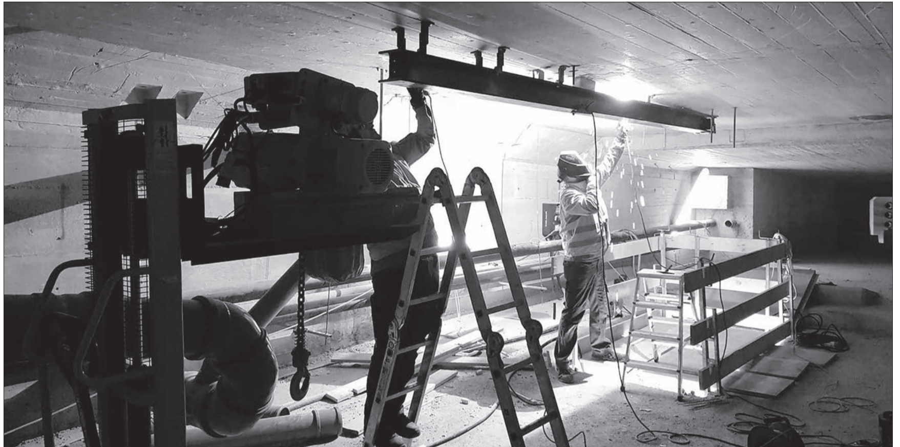
La déconstruction est une des prestations offertes par Müller Groupe, il s'agit de démonter des éléments avec vigilance afin de pouvoir les réutiliser
