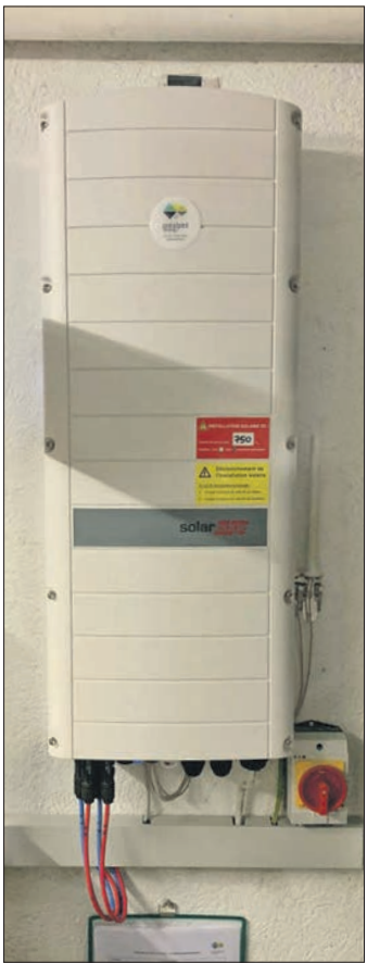
L'onduleur est nécessaire pour transformer le courant continu en courant alternatif
